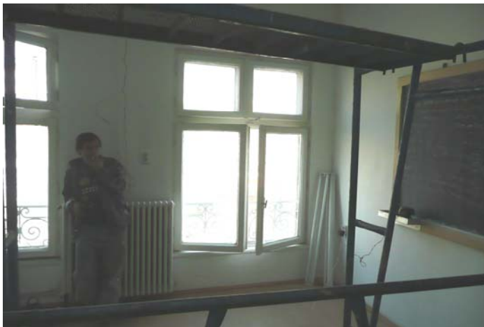
Tamplaria initiala in stare avansata de degradare
